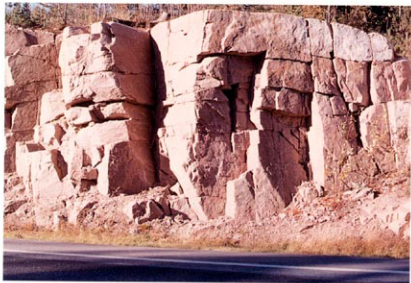
Figur 11. Hard sprengning er karakterisert ved at borchullene i konturen ikke er synlige, sterk oppbrytning langs oppsprekningen i berggrunnen, og stor bakbrytning med store overmasser som resultat. På bildet er oppsprekningen gunstig, slik at det ikke er oppstått rasfarlige partier i skjæringen. (Foto: A. Grønhaug)
